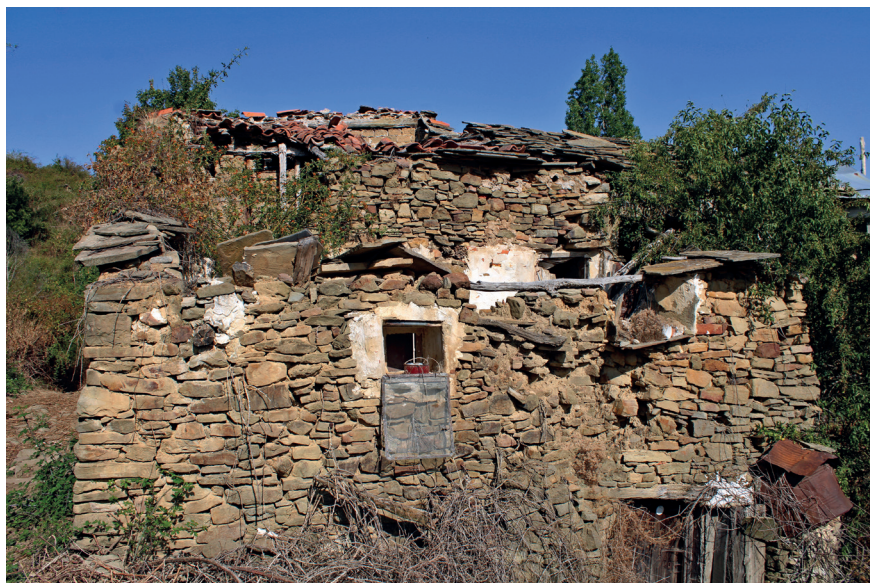
Lám. 4. Arquitectura tradicional doméstica en ruinas. Bucesta.
